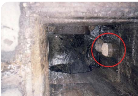
2-Arch터널 배수맨홀 막힘 현상
